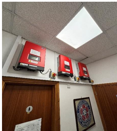
29. Solar PV Inverters
